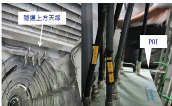
隧道施工方式雪山隧道中裝置之天線及 POI 設備
